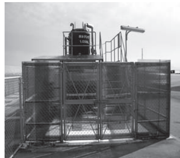
海洋深層水原水タンク
